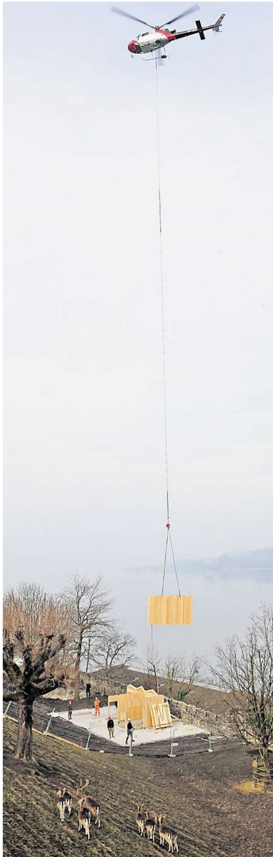
Der Helikopter transportiert eine Wand zum Stall in den Hirschpark – aufmerksam beäugt von den Damhirschen. Bilder: Kurt Heuberger
